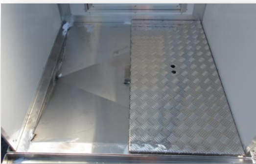
Spitzförmige Abflussvorrichtung & Alu-Riffelblech Boden
