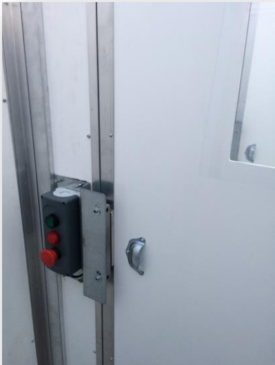
Zwangsverriegelung der Duschkammertüren
