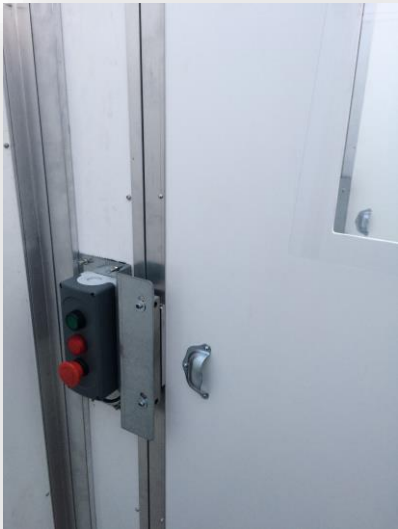
Zwangsverriegelung der Duschkammertüren
